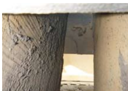
Разрушения поясных уголков продольных балок на 1201-ом км (ПК1)
